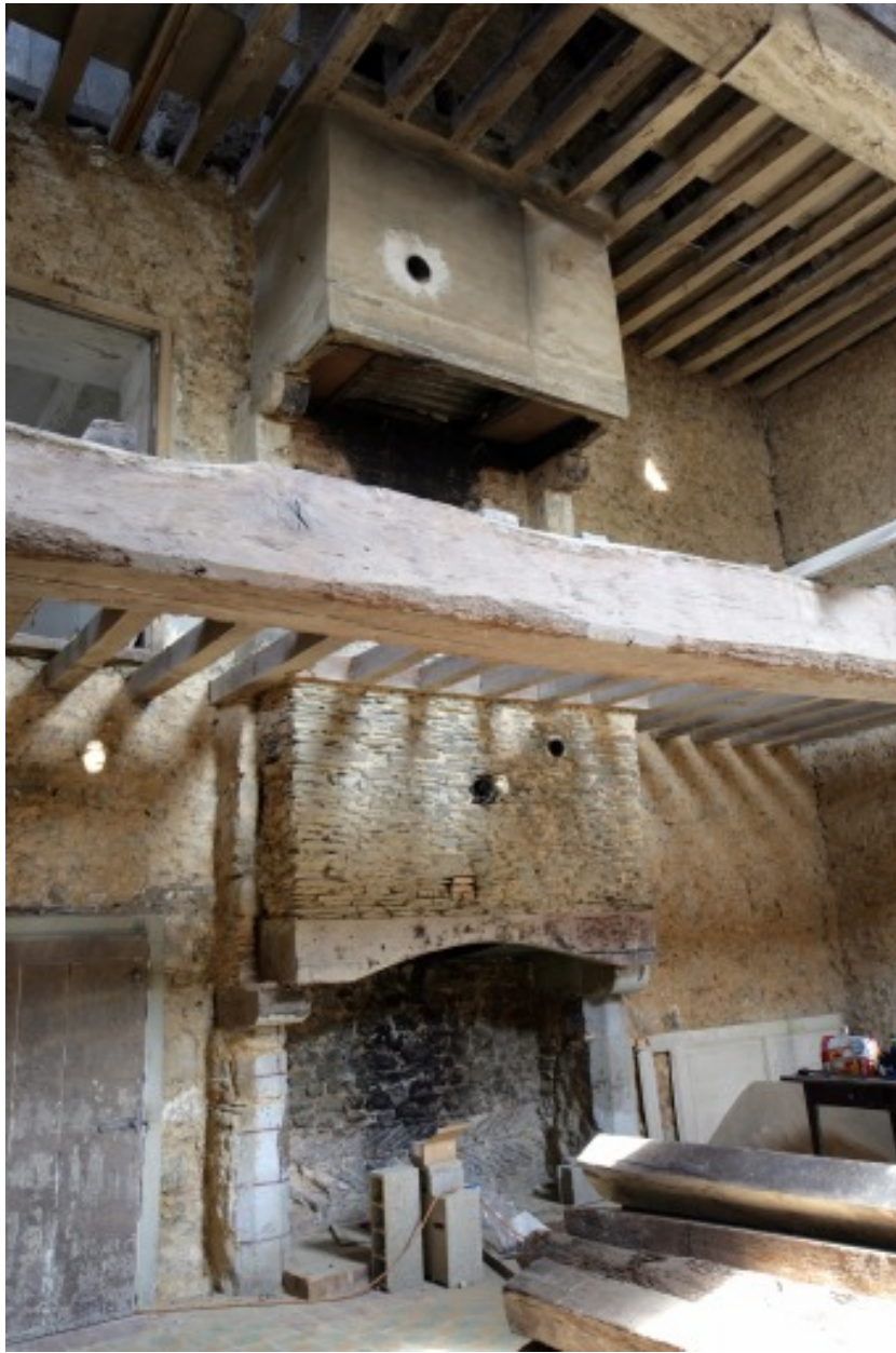
Intérieur du corps sud pendant les travaux : vue des deux premiers niveaux depuis le sud-ouest.
