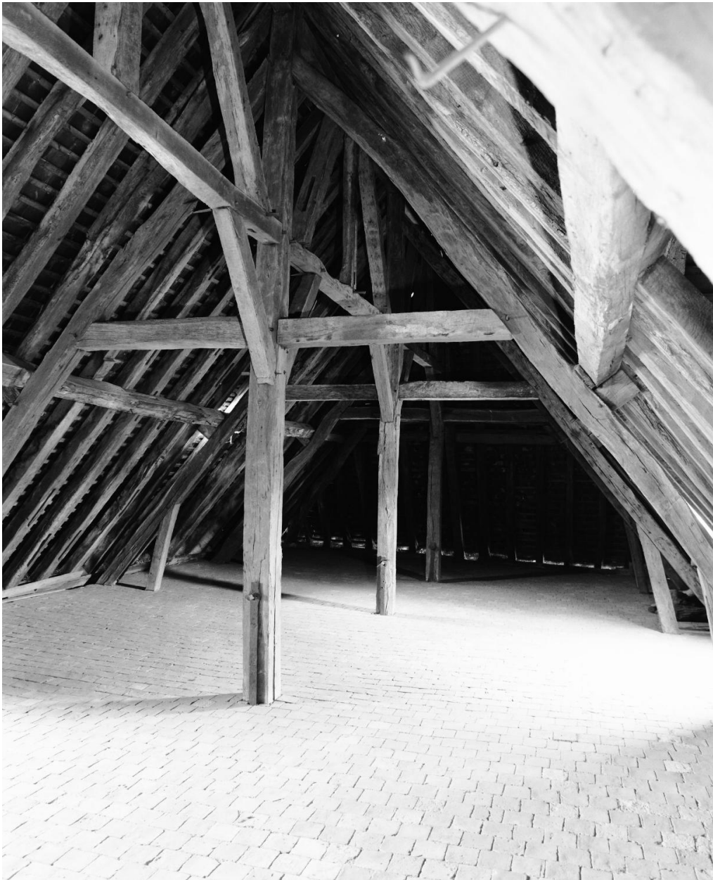
Corps de bâtiment de la grande sacristie et de la salle du chapitre, étage de comble : vue d'ensemble de la charpente en axe nord-sud.
