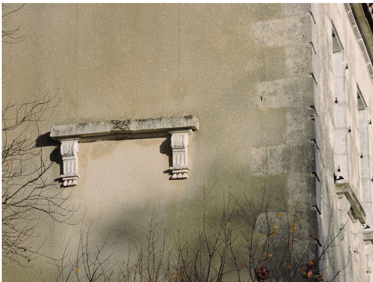
Appui d'une ancienne baie sur le mur pignon ouest de la maison.
