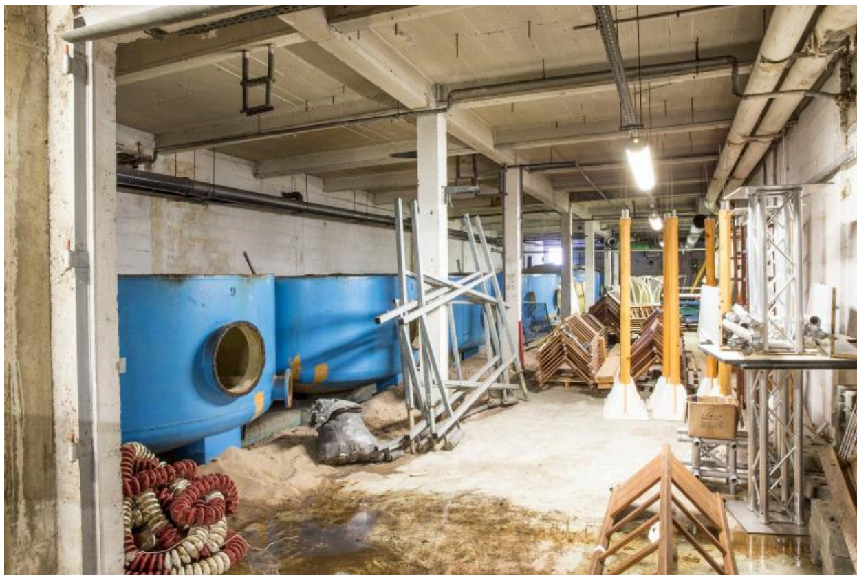
Vue des filtres à sable de la piscine.
