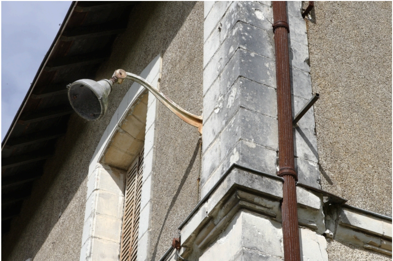
Eclairage extérieur (début XXe siècle).
