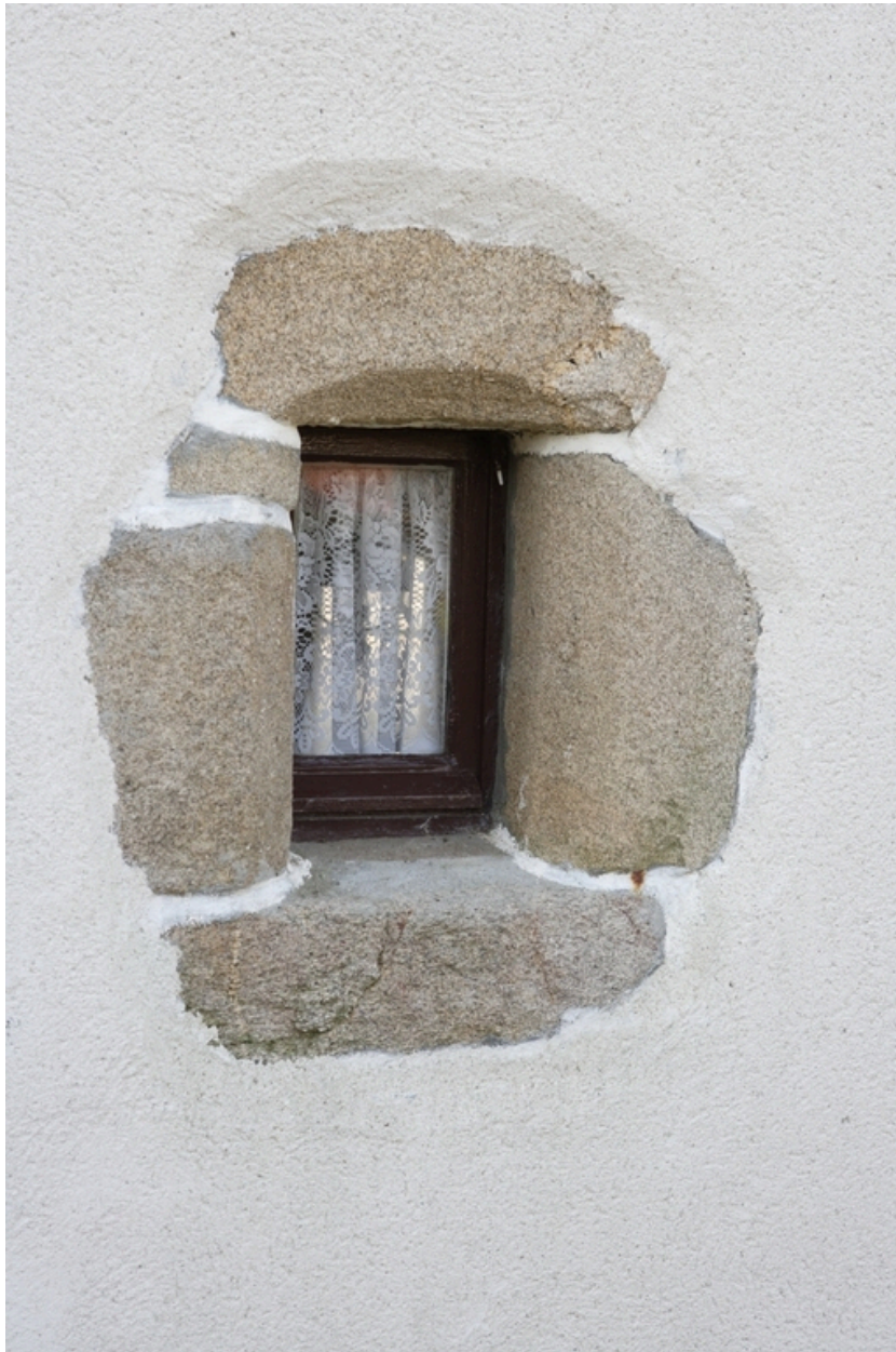
Détail du jour du rez-de-chaussée du 2e logis (2 rue de la Croix).
