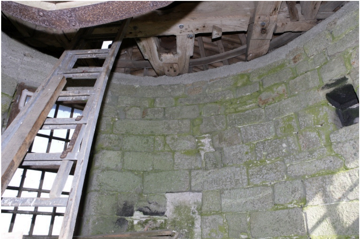
Intérieur de la cage. Détail d'une partie de la civière.
