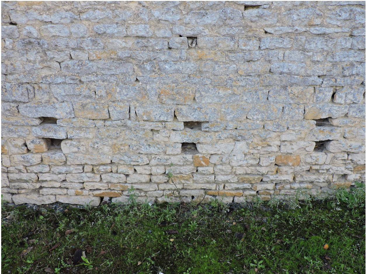
Orifices pour attacher les animaux, à la base du mur de la grange-étable.
