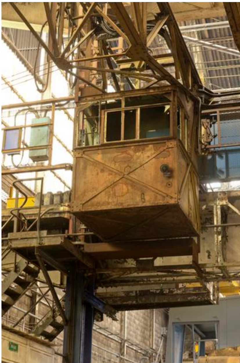
Détail d'une cabine de pont roulant.
