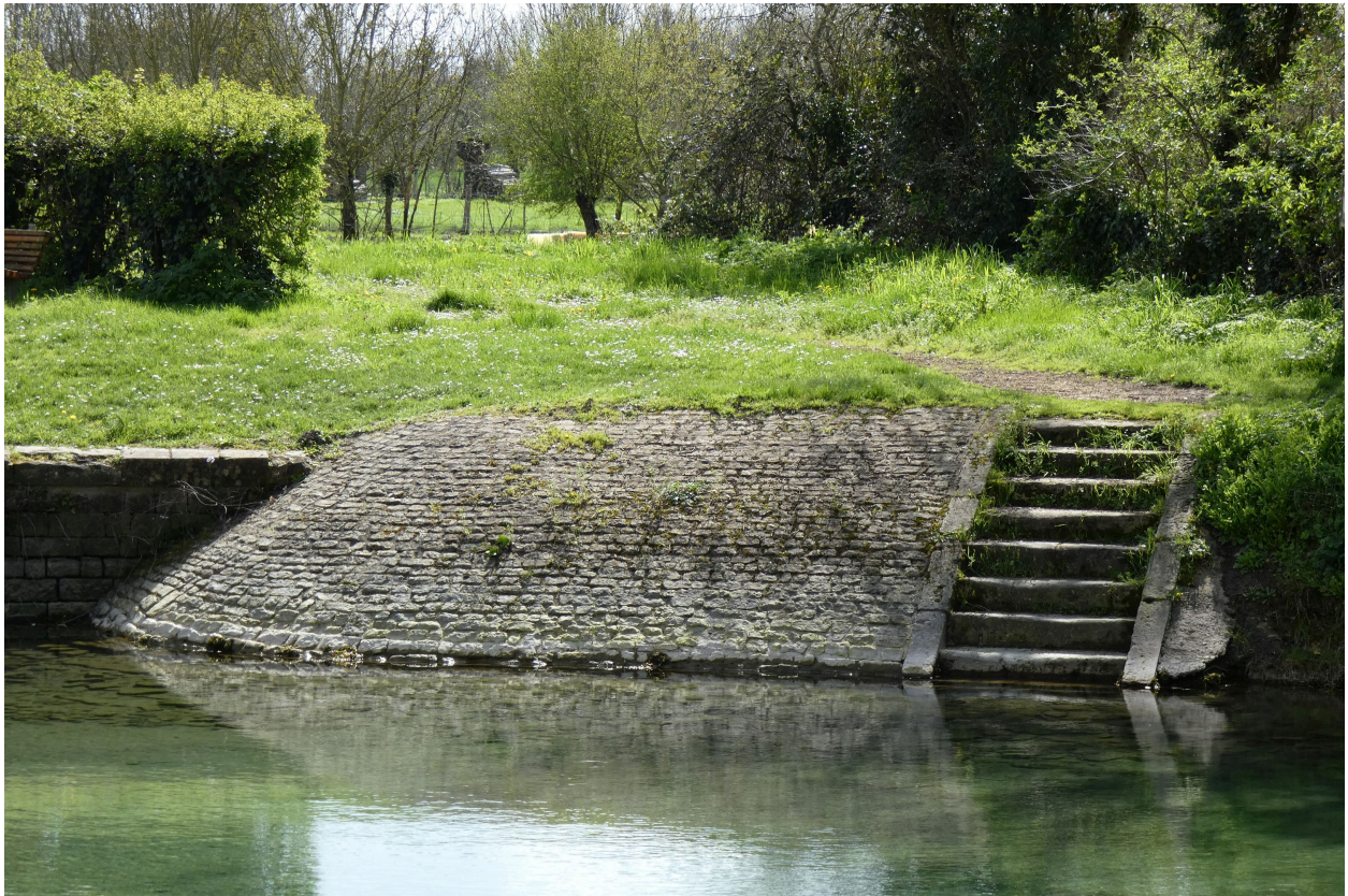
Le perré en arc de cercle et l'escalier à l'extrémité ouest du quai sud.
