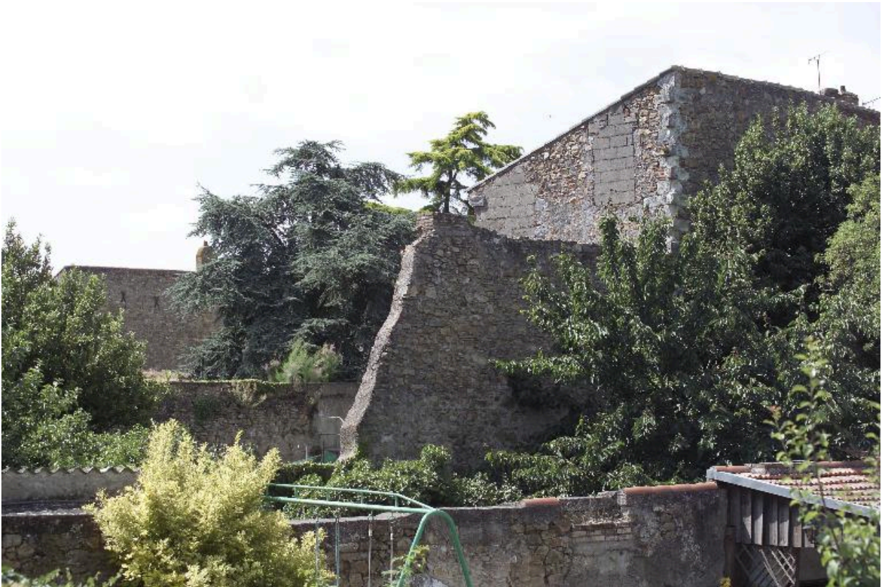
Vue du corps secondaire depuis le jardin de la maison n° 7 de la rue.
