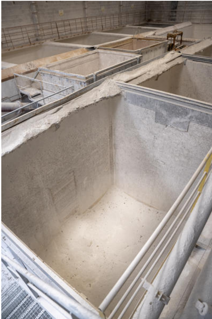
Détail des cuves de préparation du couchage de l'atelier J.
