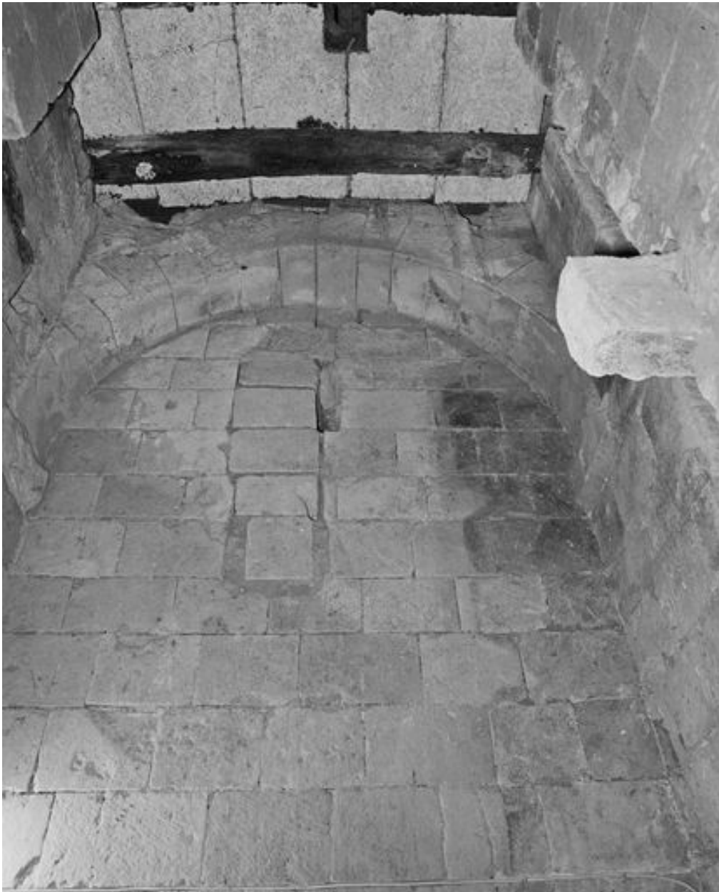
Sous-sol, système hydraulique, puits central des latrines (?).
