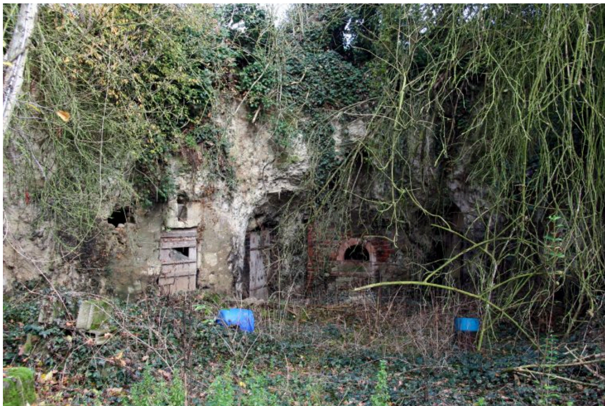
Dépendances troglodytiques en partie effondrées (pressoir, caves, boulangerie)
