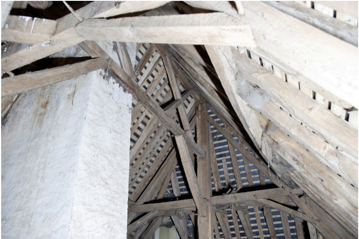
Comble du pavillon : la partie supérieure de la charpente vue depuis le nord.
