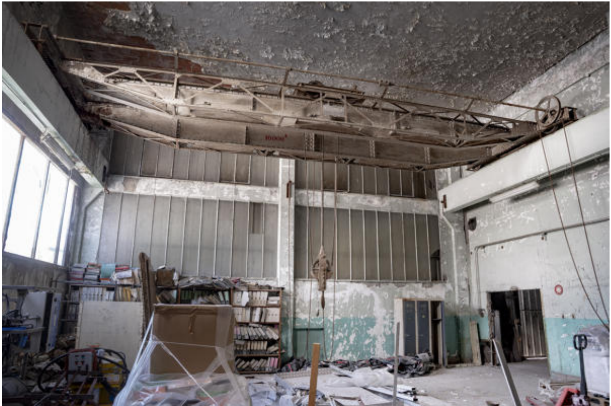
Extension de la chaufferie et son pont roulant, usine de papeterie.
