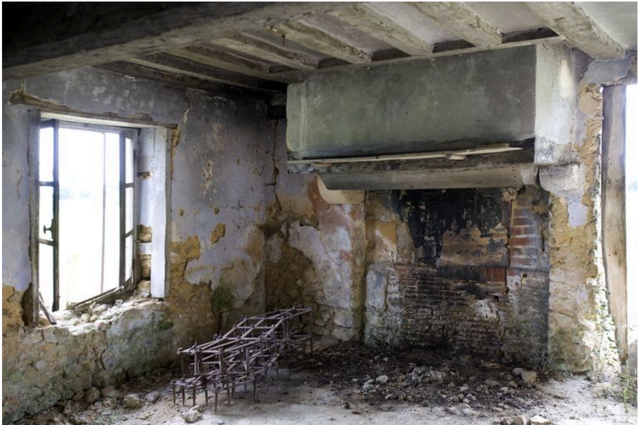
Vue intérieure de la chambre à feu.
