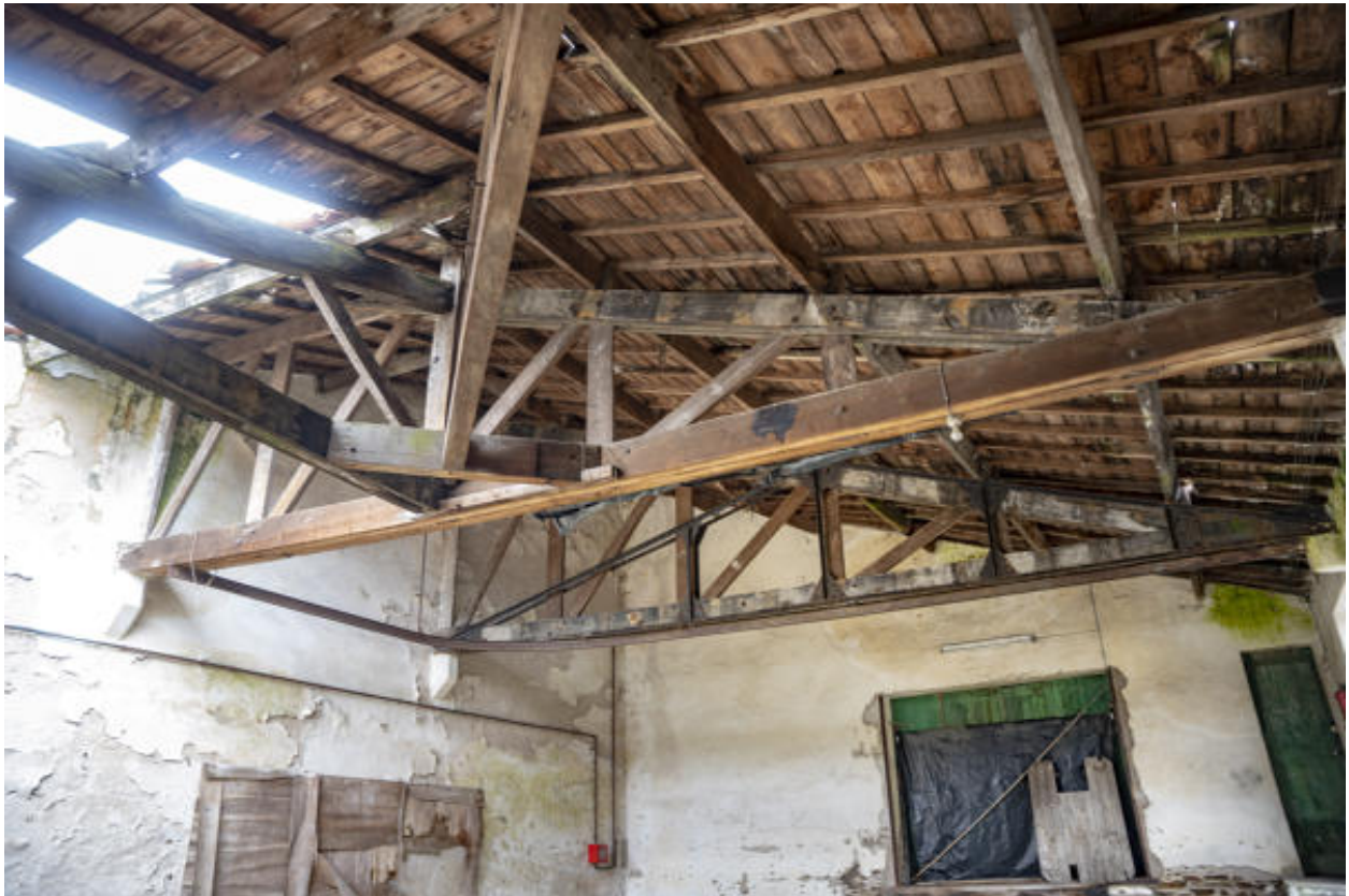
Salle dédiée au lavage des bouteilles, détail de la charpente en partie effondrée.
