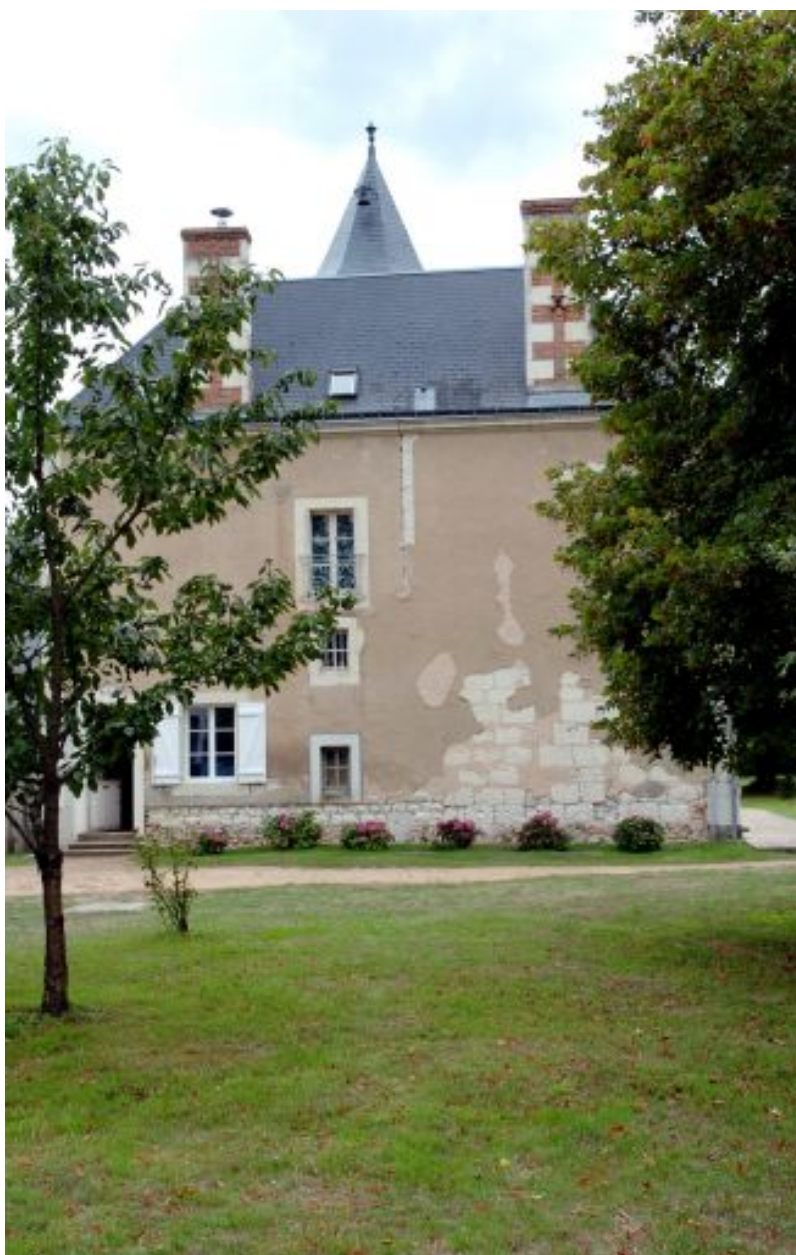
Façade postérieure : trace de collage.
