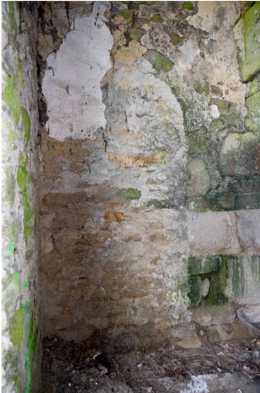
Détail de la porte bouchée sur le pignon ouest du 1er logis.
