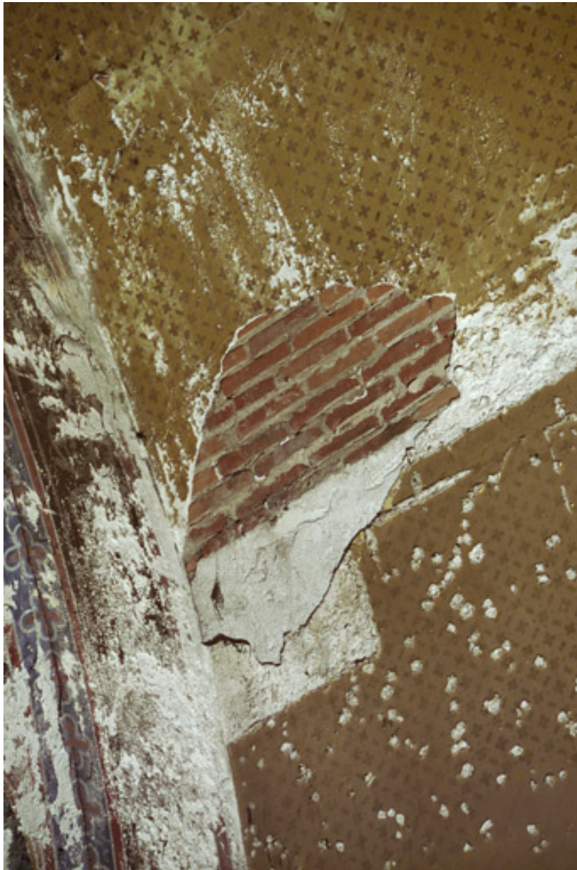
Détail du parement en brique de l'abside sous la toile endommagée.
