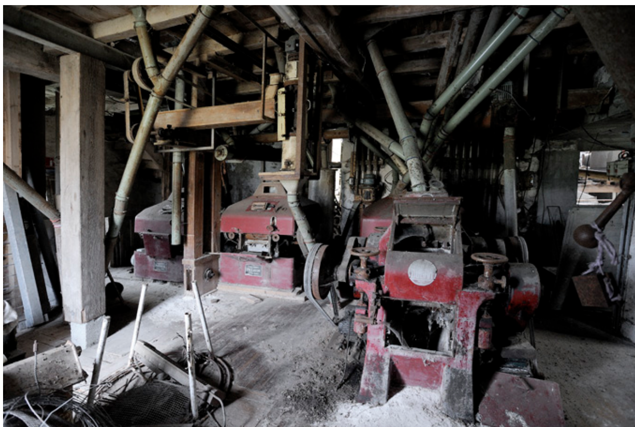
Broyeurs situés au premier étage.
