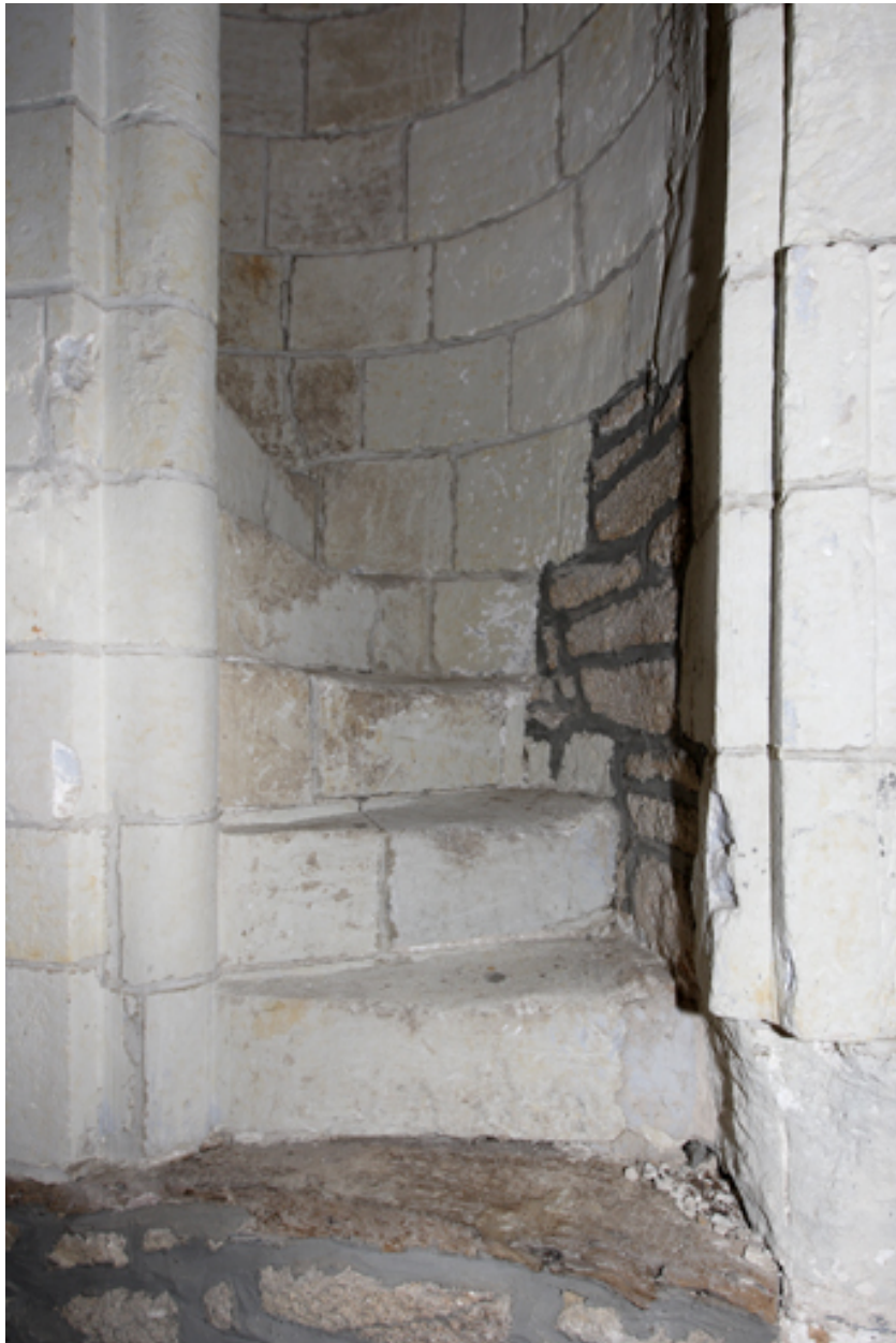
Logis. Cage d'escalier. Second palier. Départ de la vis d'escalier au niveau du comble.
