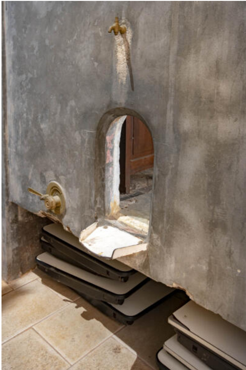
Cuve aérienne désaffectée.
