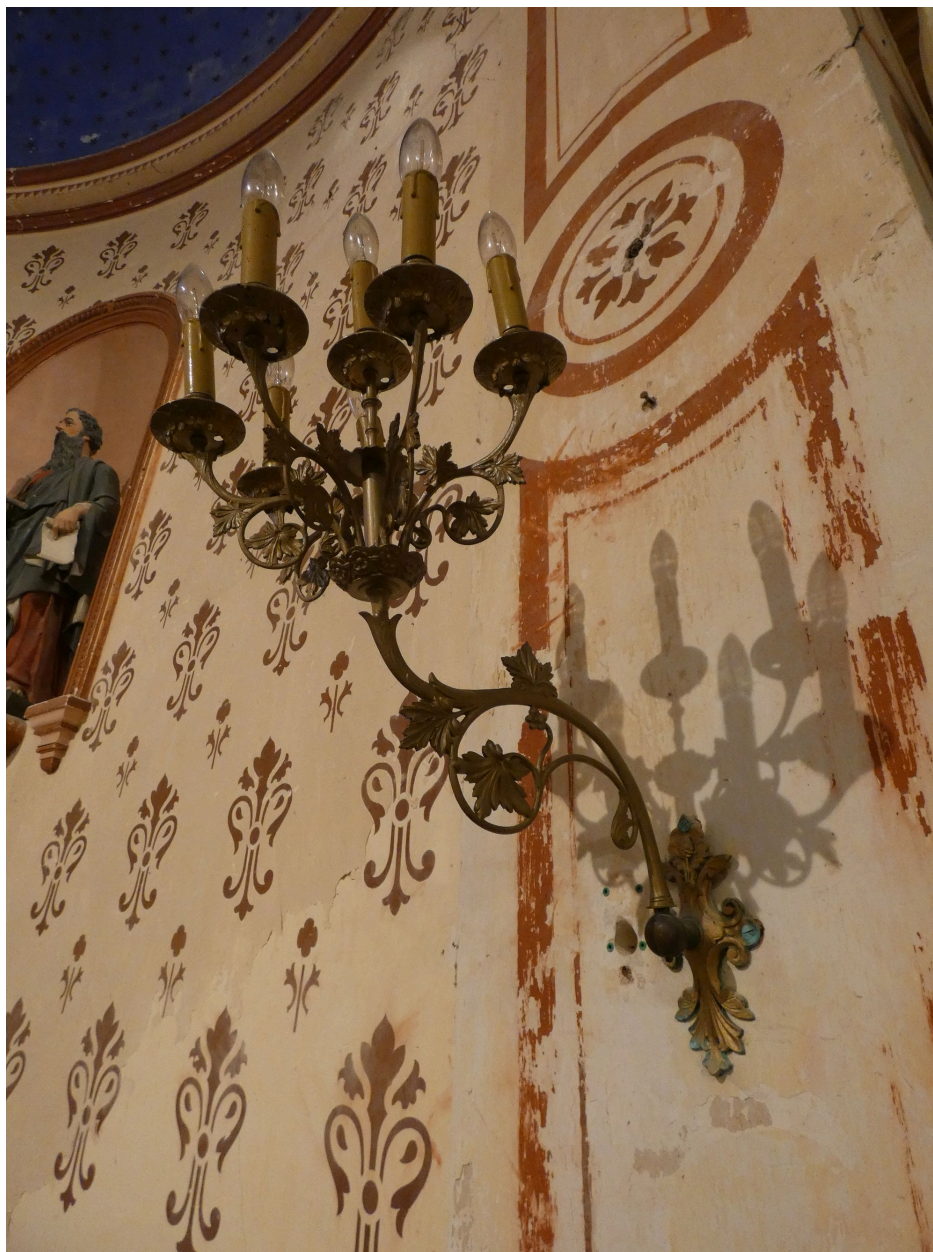
Un des deux luminaires du choeur.
