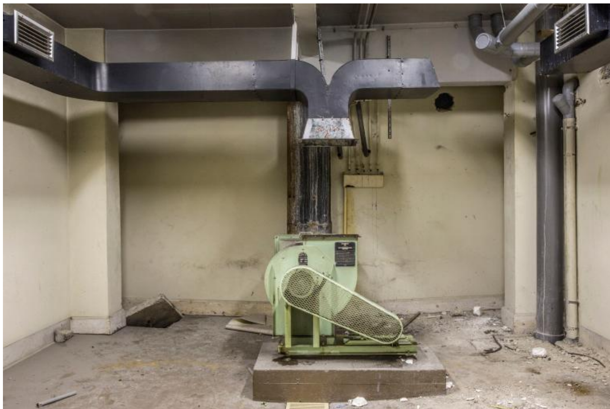
Vue de la chaufferie des vestiaires de la piscine.
