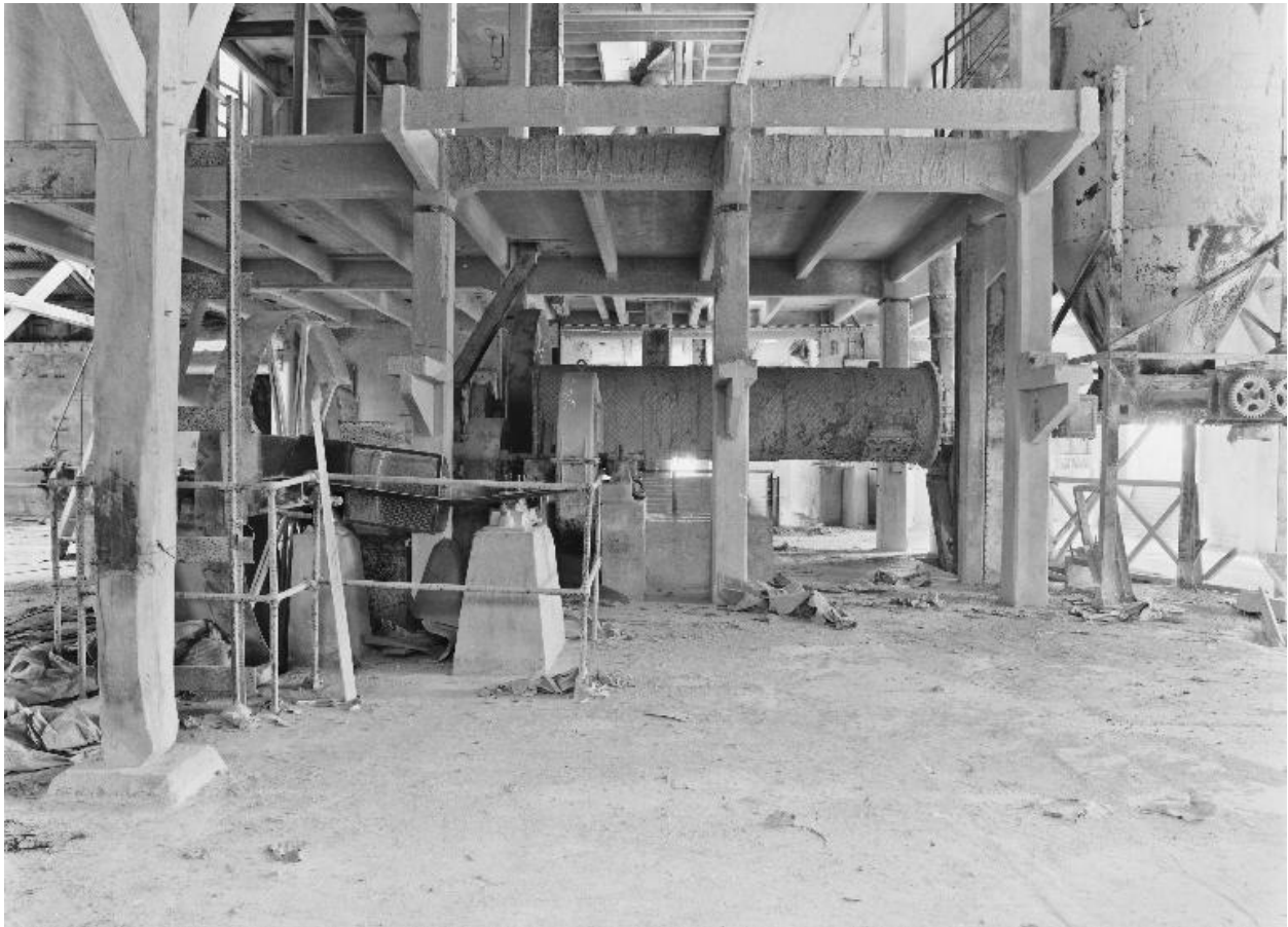
Usine de chaux, atelier de blutage ; bluterie, roue principale de transmission d'energie et fondations du moteur à gauche
