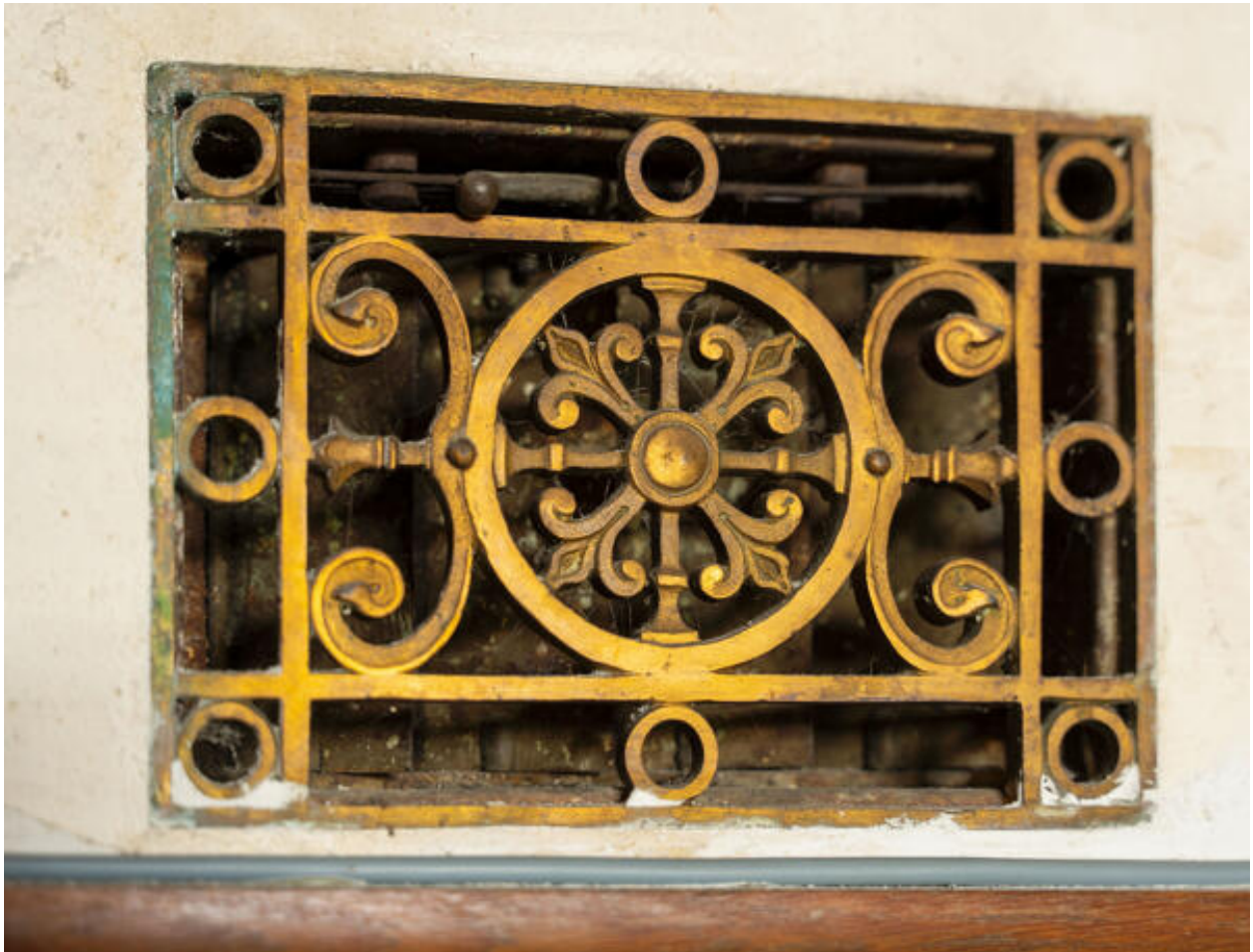
Une plaque du système de chauffage.
