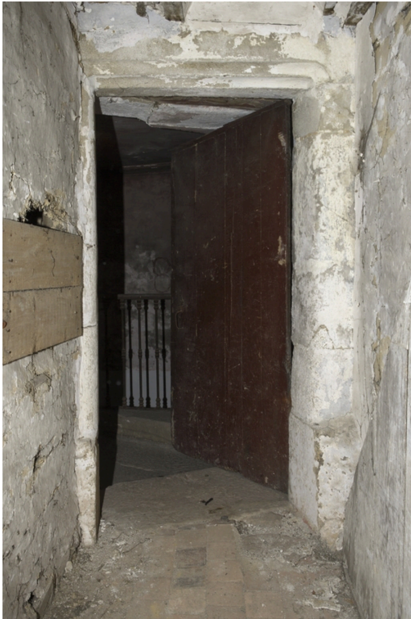
Logis. Tour d'escalier. Détail de la porte ouvrant sur les combles de l'aile est.
