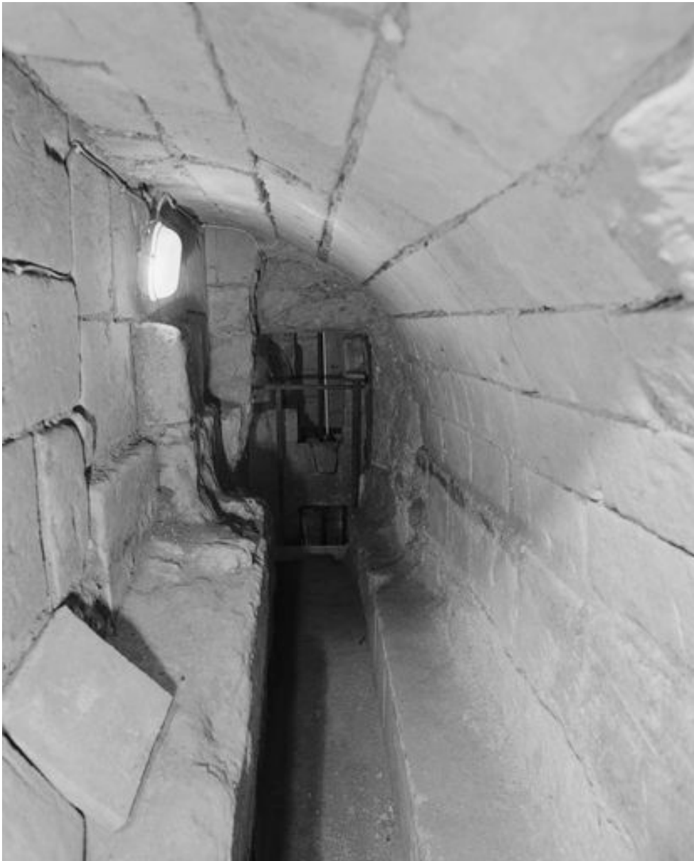
Sous-sol, système hydraulique, détail des canalisations.
