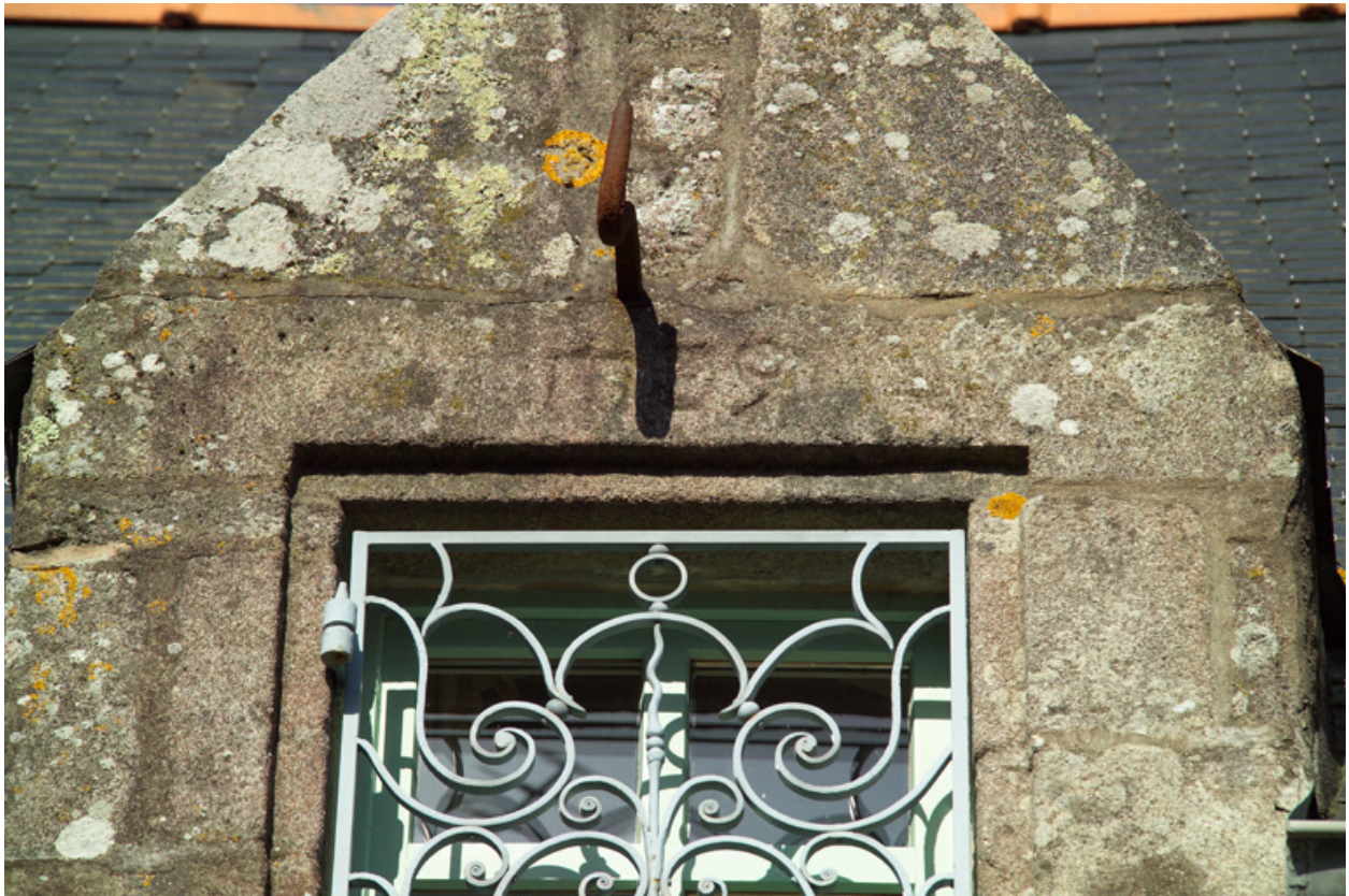
Façade sur rue, détail de la date gravée sur le linteau et de la grille en fer forgé.
