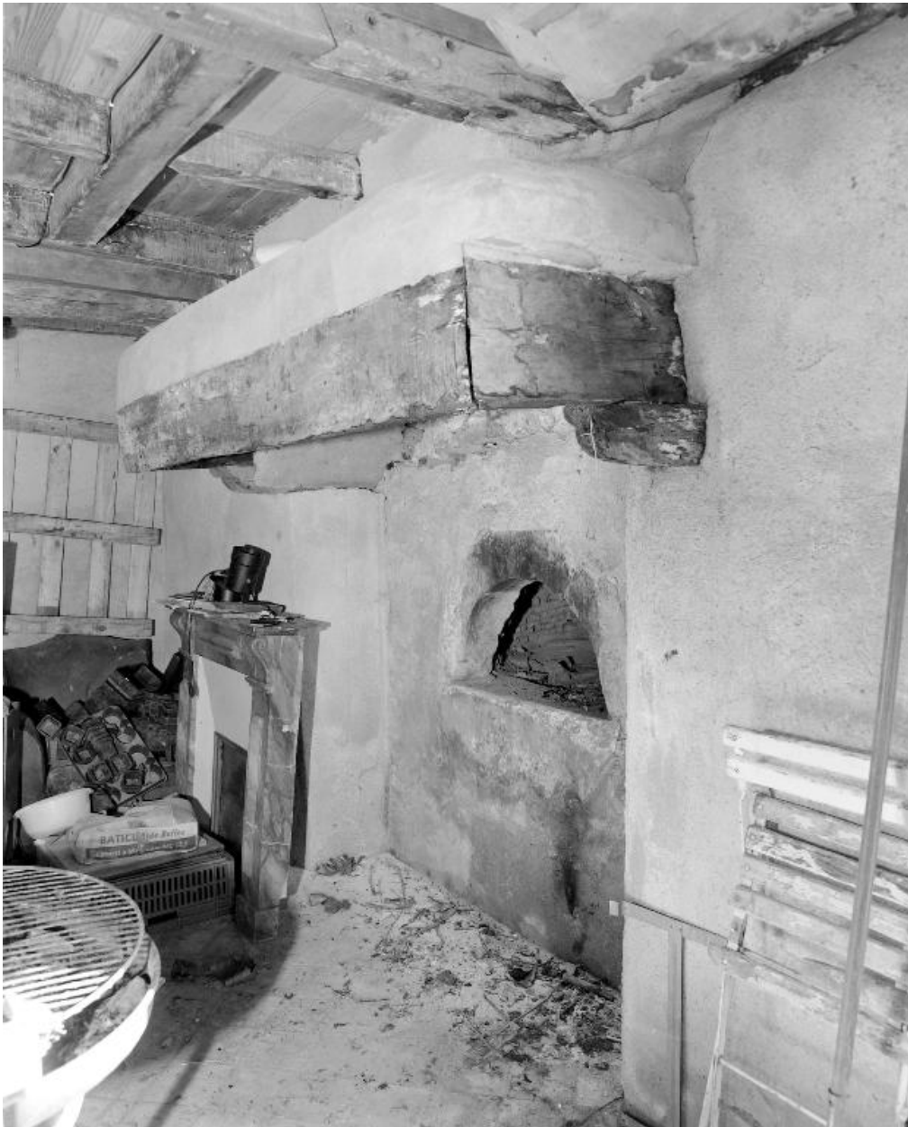
Vue intérieure du fournil : le four à pain.
