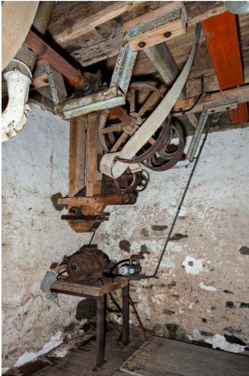
Rez-de-chaussée, angle nord-est : le moteur d'appoint de la roue (Moteurs Ch. Roulland, Vincennes, moteur asynchrone triphasé, type PL1202k, N°551947).
