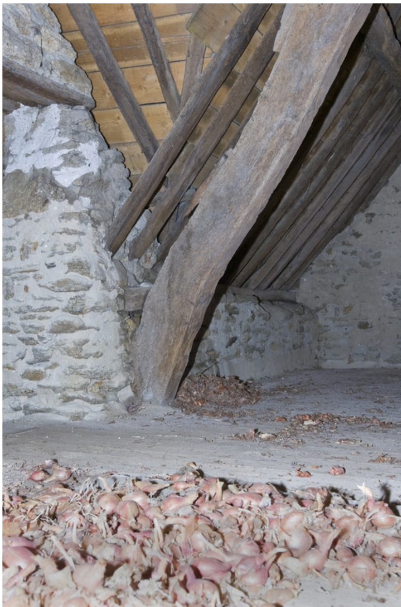
15 rue Jeanne-de-Navarre. Comble. Départ de l'arbalétrier.
