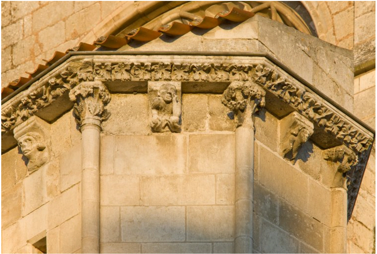
Vestiges de la tour d'escalier à gauche du bras nord du transept : partie centrale.
