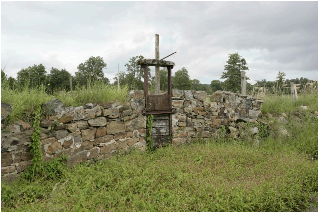
La vanne de décharge de l'étang de retenue.
