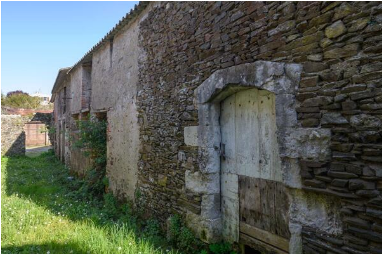
Vue d'ensemble des dépendances à l'arrière du 10 rue des Mauges (XVIIe-XVIIIe siècle).
