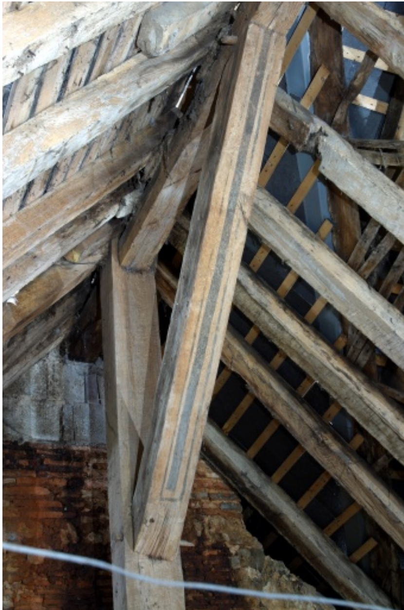
Comble du corps nord : lien de la ferme centrale, portant un décor peint..
