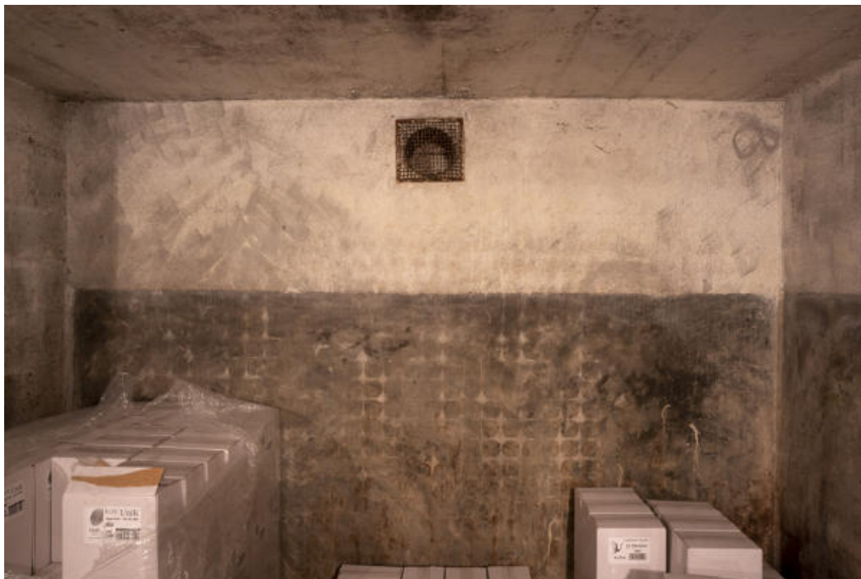
Détail d'une cellule de stockage.
