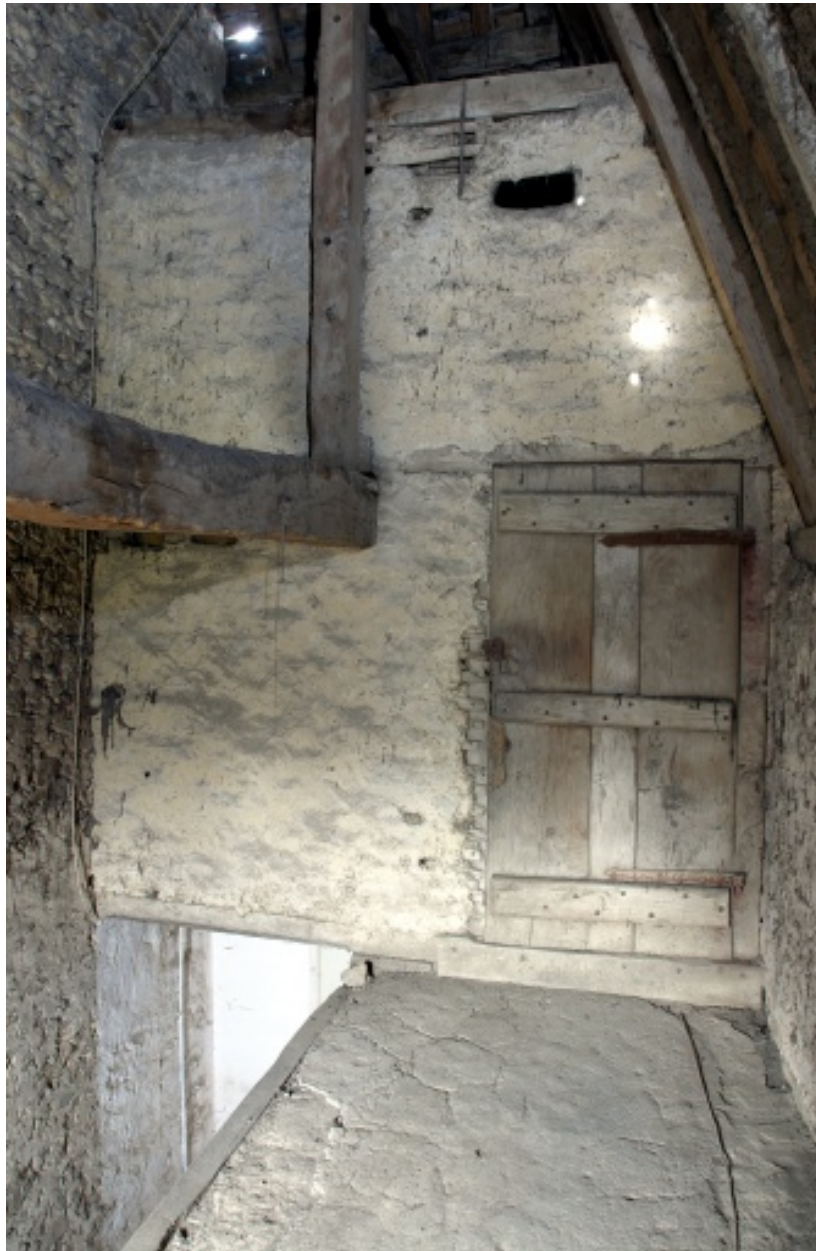
Comble de la cage d'escalier : le palier et la porte d'accès au comble de la partie sud vus depuis l'est.
