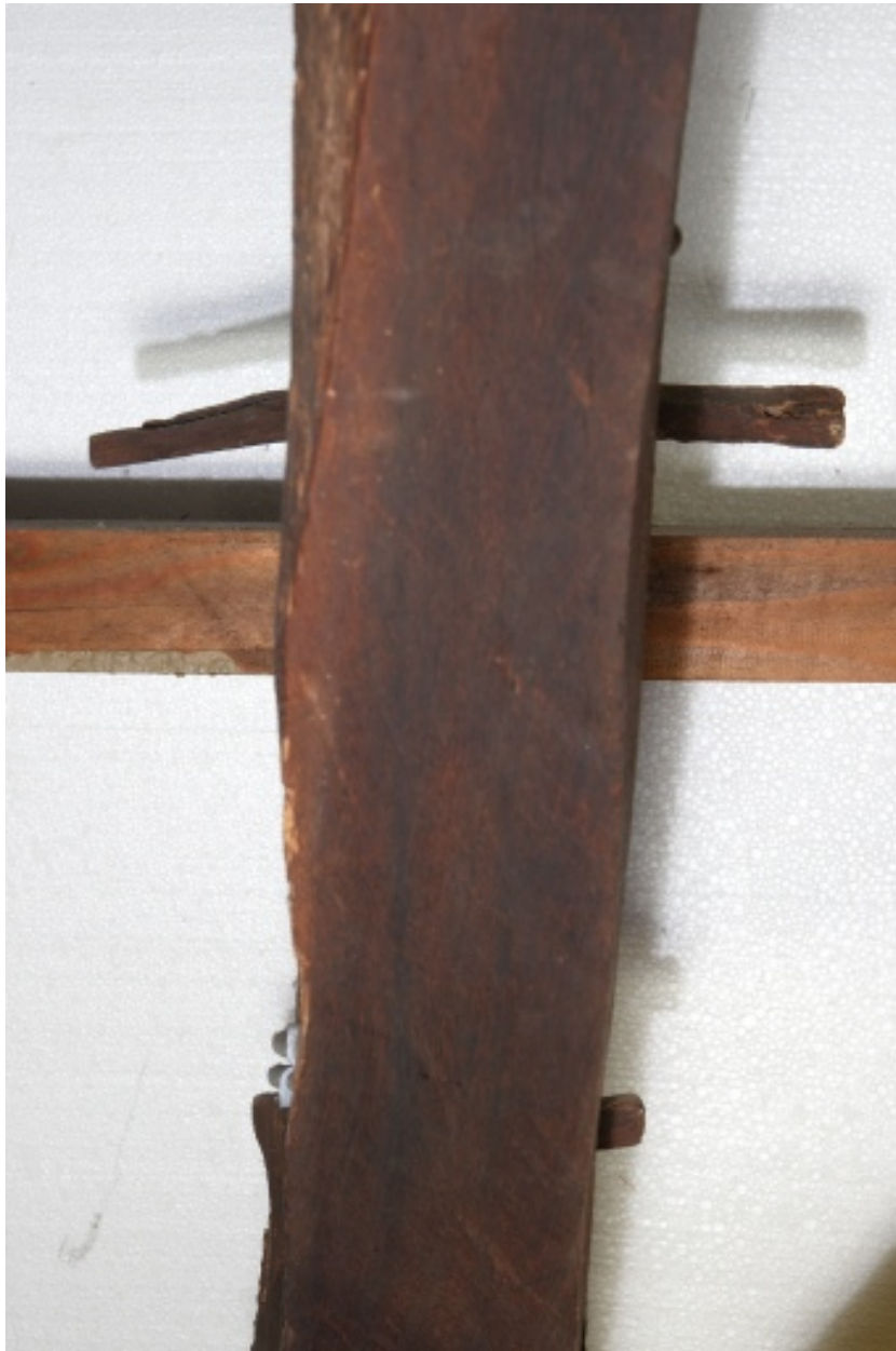
Détail d'une cheville permettant de créer un échelier sur le chevron-arbalétrier (6 rue de l'Aha).
