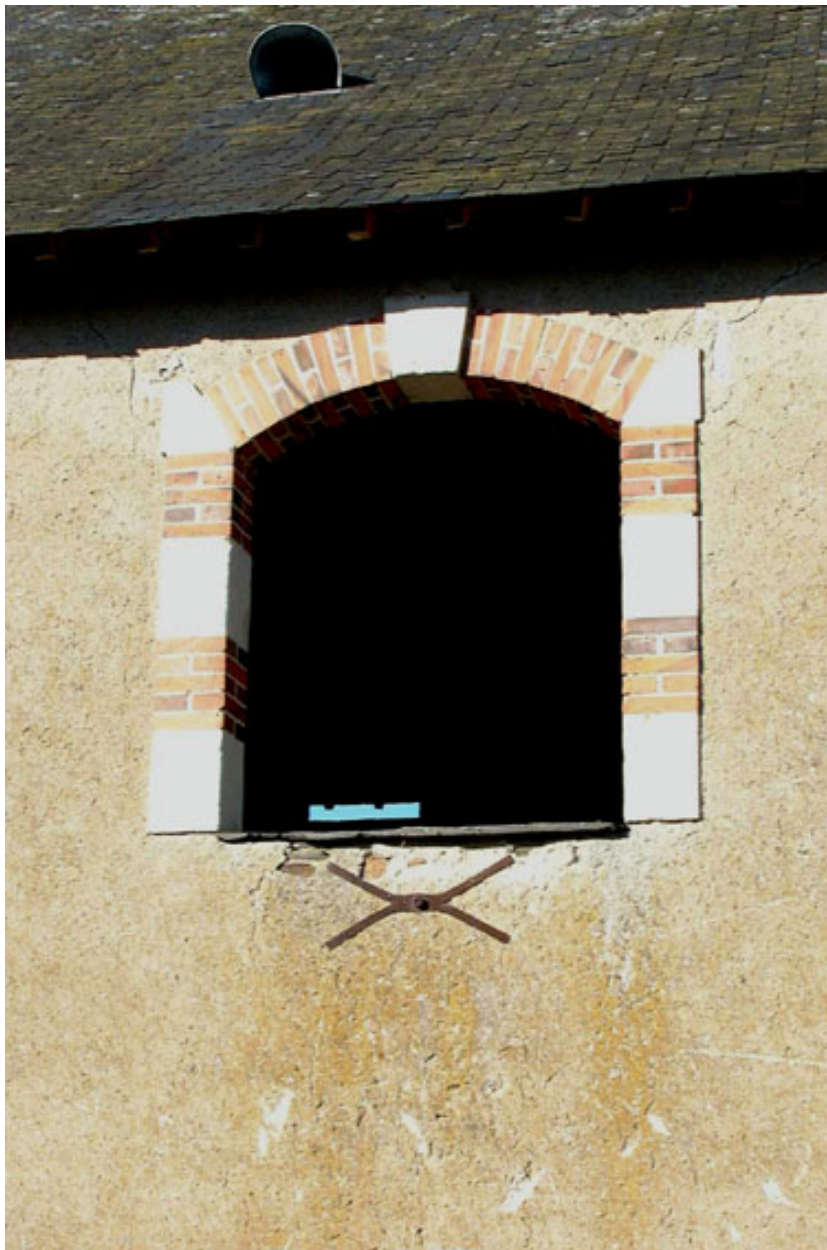
Ouverture brique et tuffeau avec arc segmentaire. Dalle de schiste pour l'appui.
