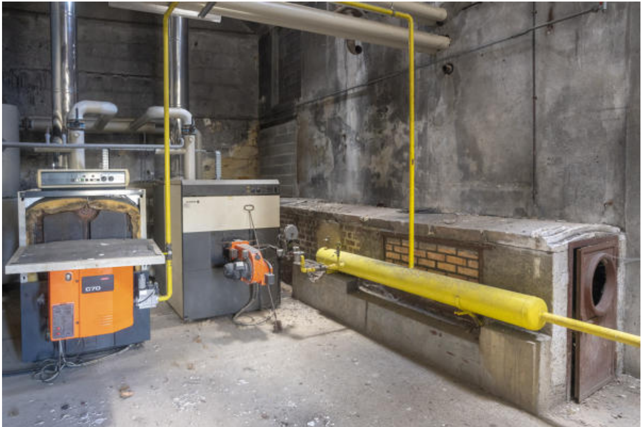
Vue intérieure de la chaufferie
