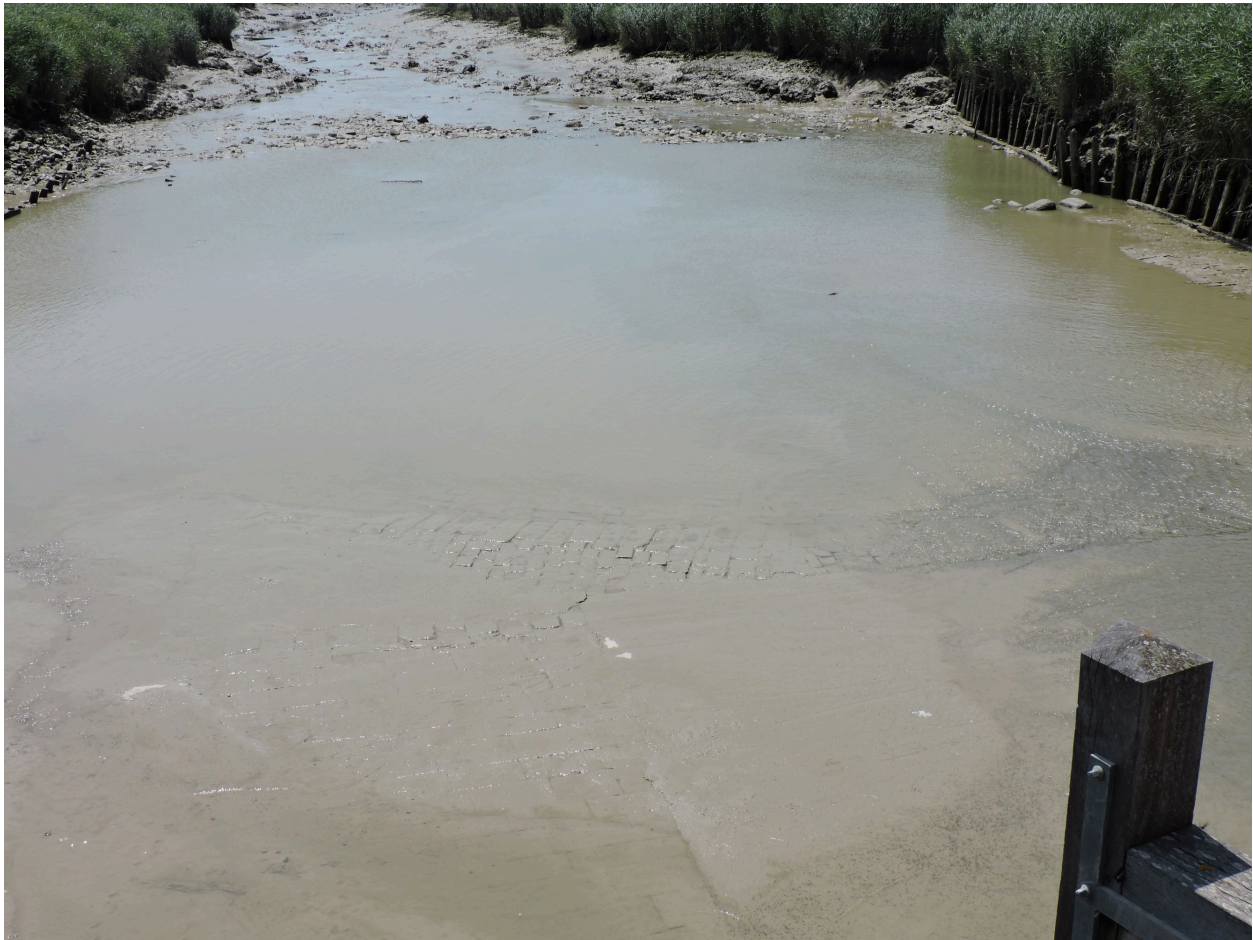
Le radier en pierre affleurant dans le chenal en aval des portes, à marée basse.
