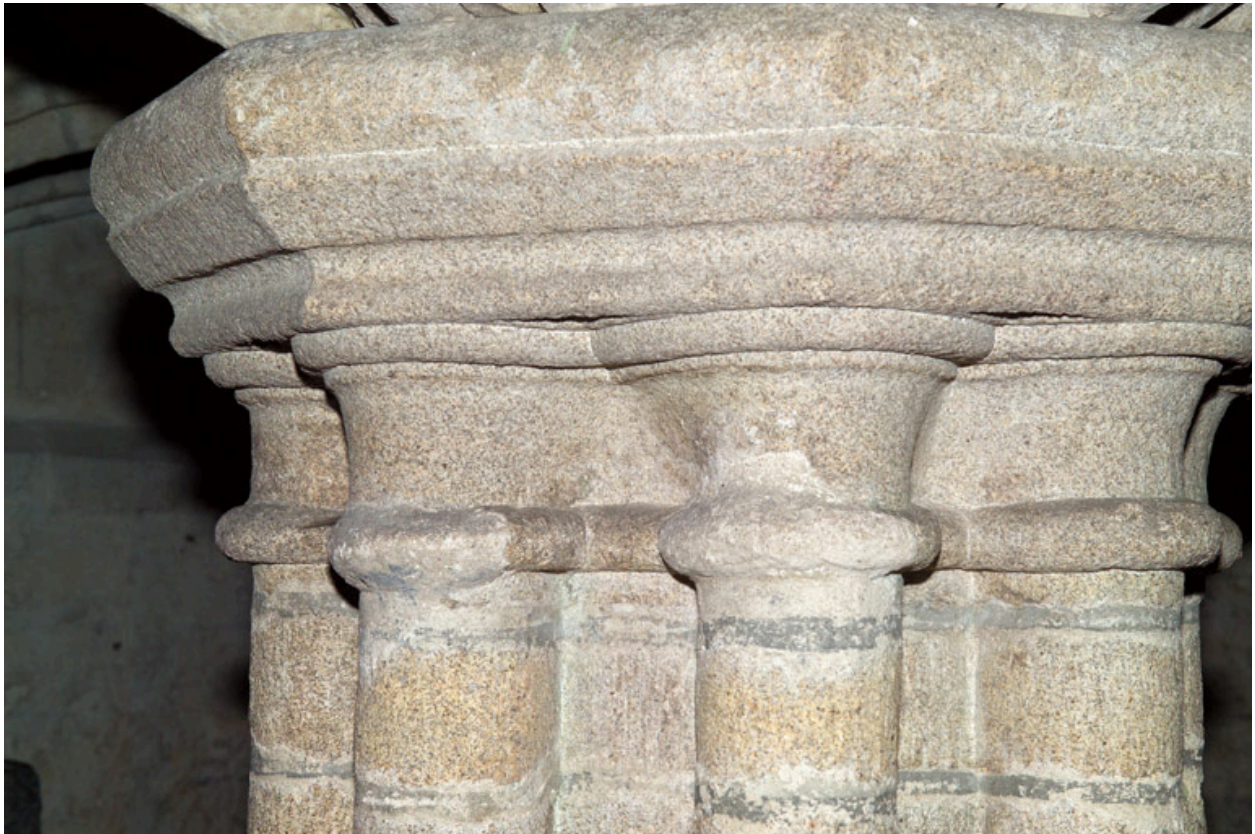
Crypte ou chapelle basse, détail du faisceau de colonnettes de la pile centrale.
