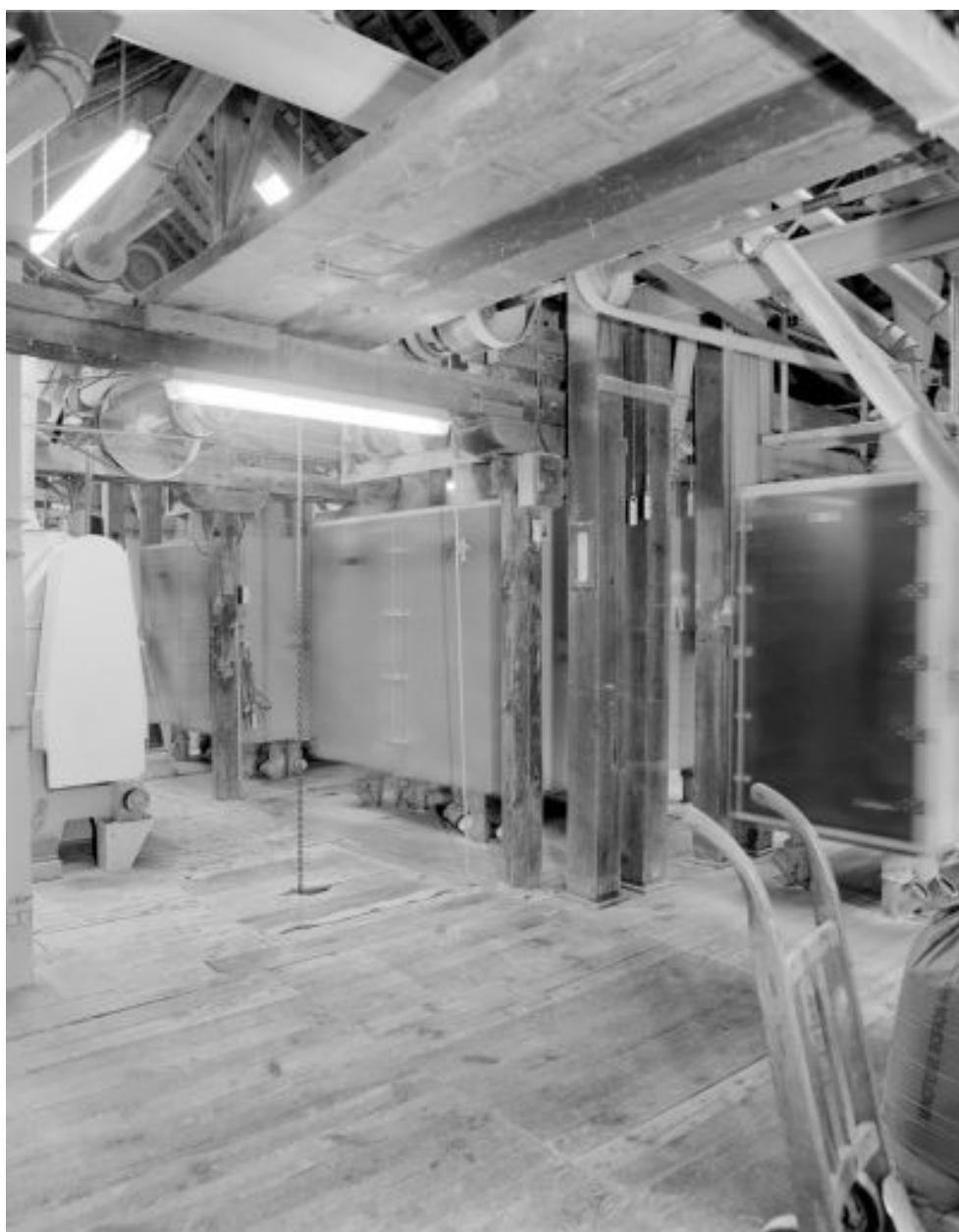
Comble. Les plansichters, vus de l'ouest.
