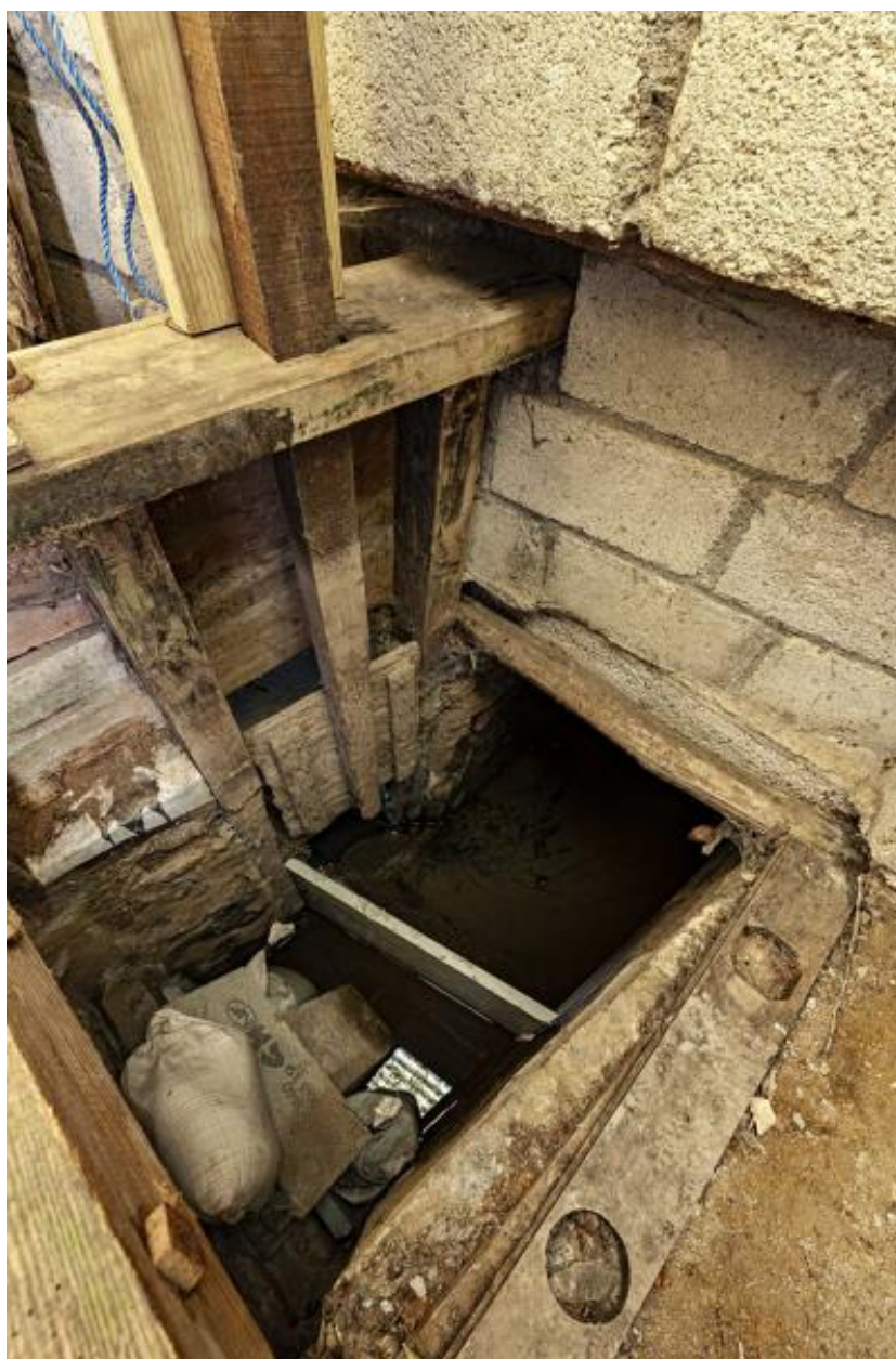
Mécanisme de contrôle des vannes.
