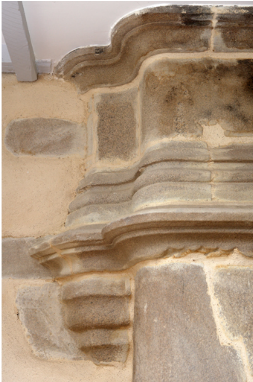
Logis. 1er niveau. Salle ouest. Détail du corps de moulures à gauche de la hotte.
