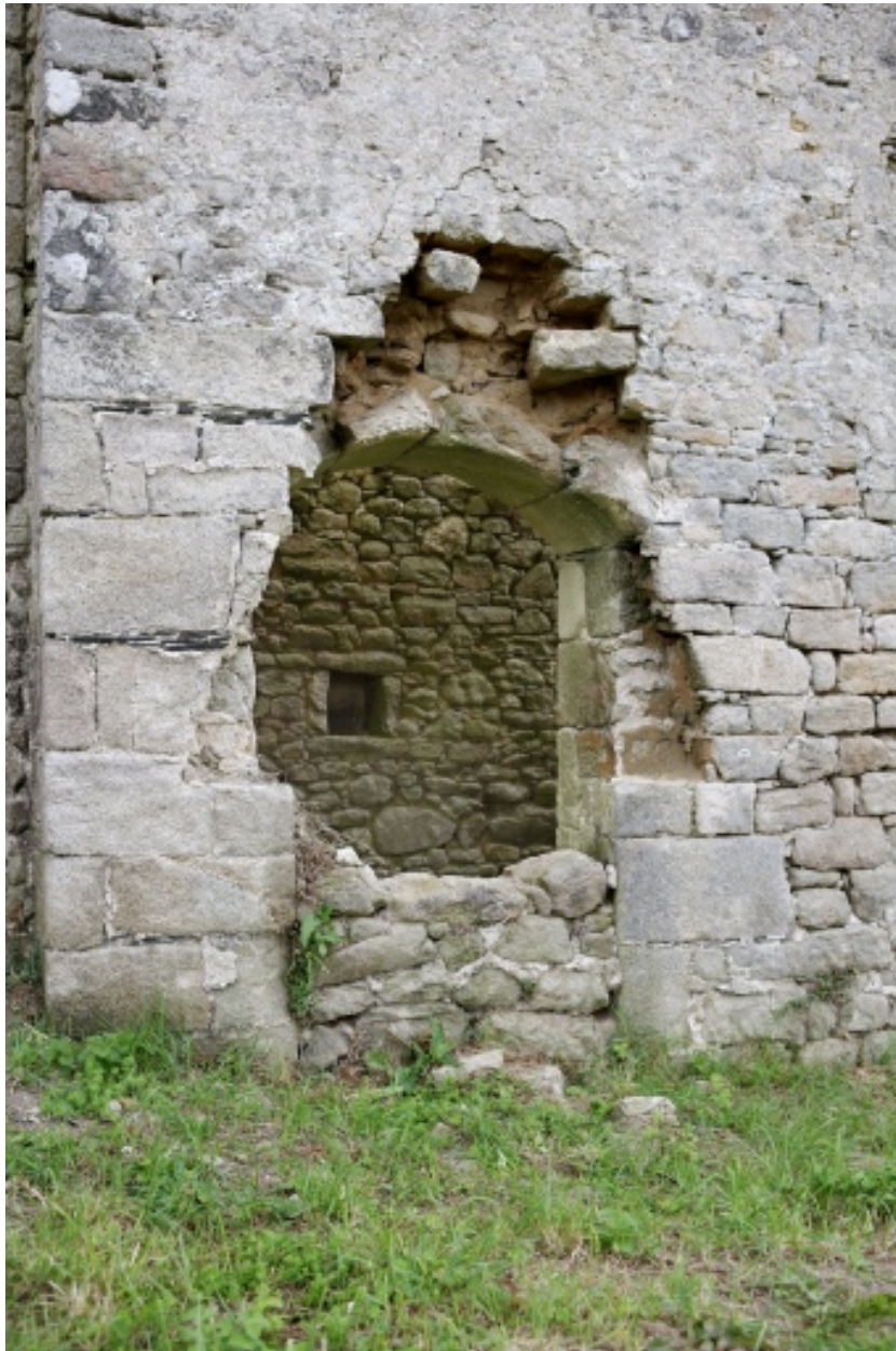
Mur de clôture ouest. Porte piétonne en ruine.
