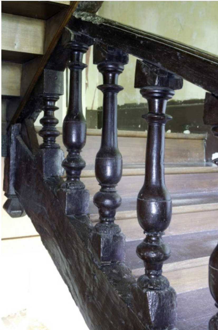
Escalier, détail des balustres avec cales entre le rez-de-chaussée et le premier étage.
